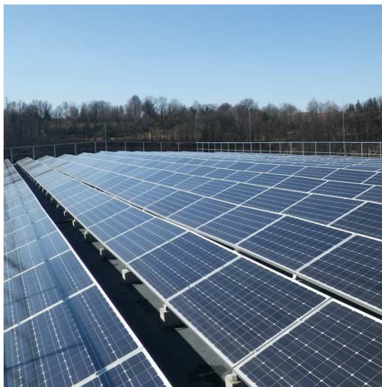
FVE Hulice - fotovoltaické panely na střeše
